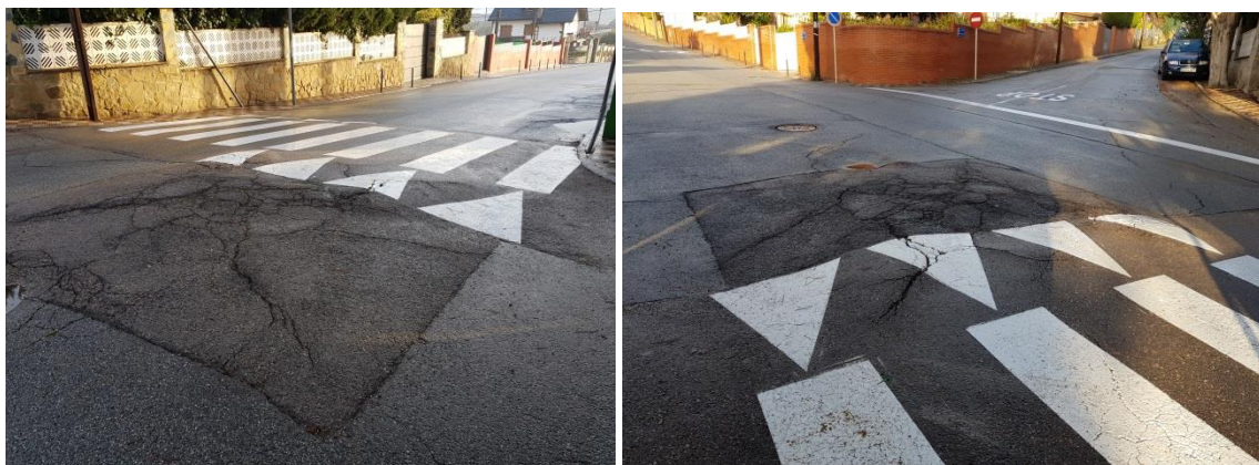
Figura 2. Detall del desperfecte del paviment per arrels a l'avinguda Roger de Llúria
