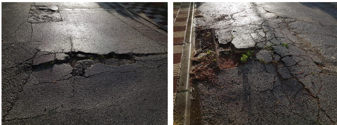
Figura 3. Detall dels desperfectes existents al carrer Doctor Barraquer a l'alçada dels pins
